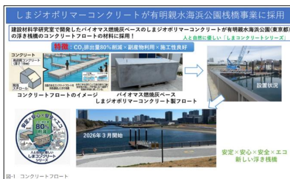
【工学部 HP より:しまジオポリマーコンクリートの採用事例】
