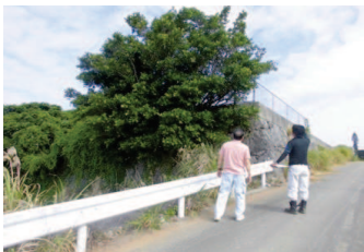
▲法面雑木・雑草繁茂確認
