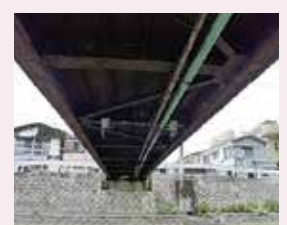
▲橋梁の腐食モニタリング
